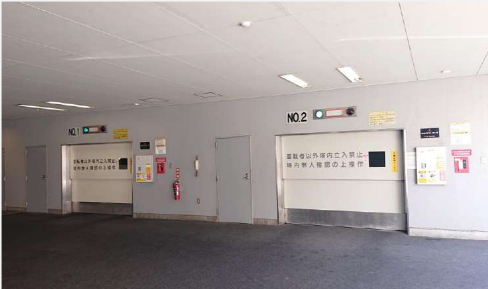
機械式駐車場
