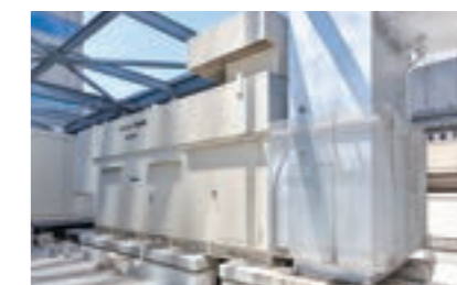
非常用発電機(屋上)
